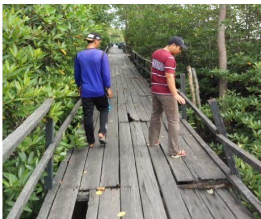
Gambar 1. Jembatan yang tidak terawat
